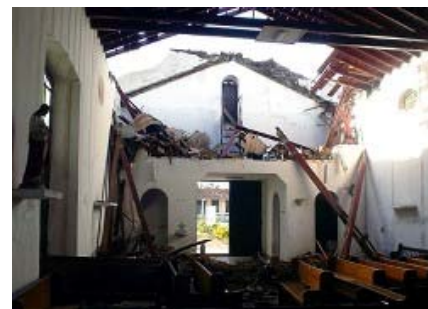
Interior de la iglesia de Los Palacios tras el paso del huracán Gustav.
